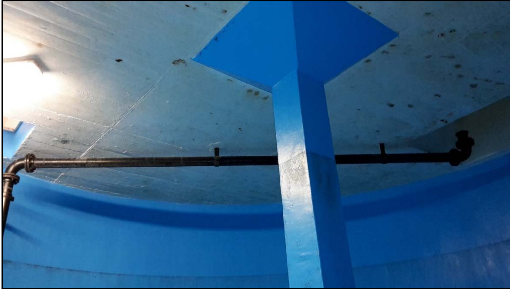
Abbildung 17: „HB Saulach“: Roststellen an Behälterdecke in rechter Wasserkammer
