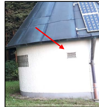
Abbildung 12: Lamellen-Lüftungsöffnung im HB Breitenbronn
