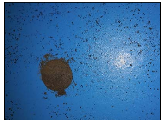
Abbildung 14: Punktförmige Ablösung der Beschichtung im „HB Saulach“ (links);
