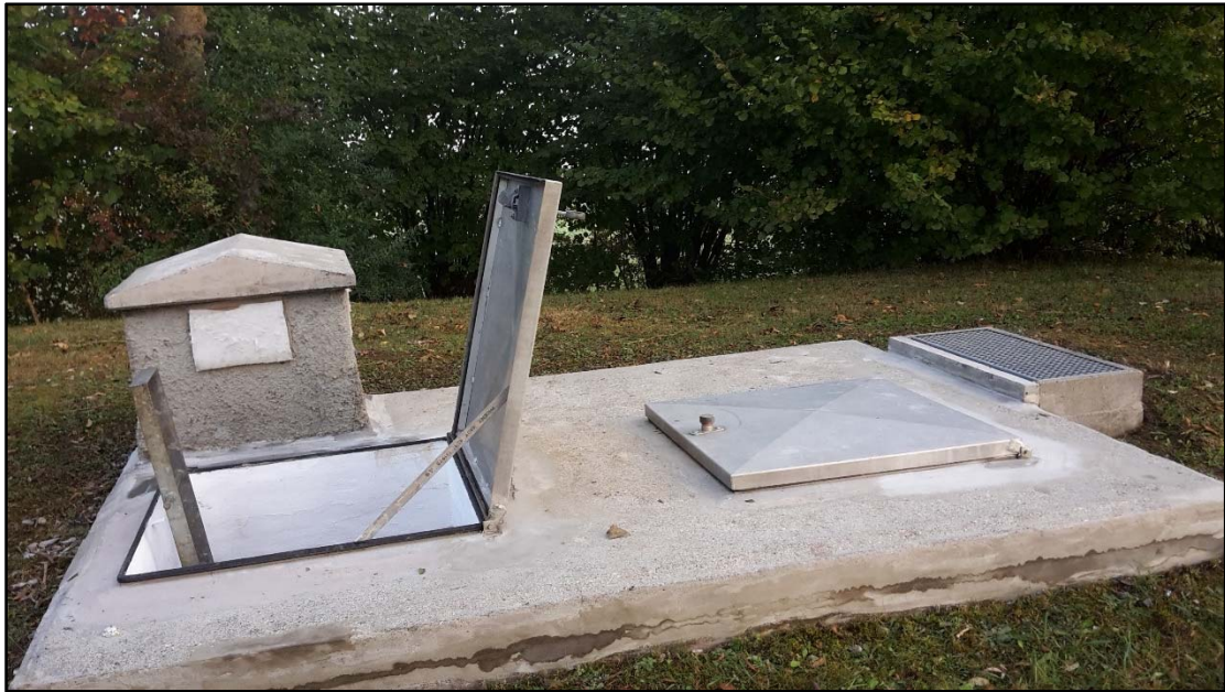
Abbildung 8: Gitter an der Geländeoberfläche und Belüftungsdom bei Brunnen II
