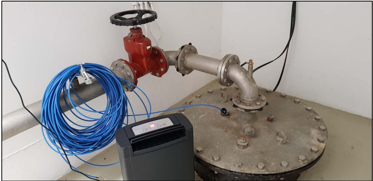
Abbildung 7: Löcher und undichte Stelle bei der Kabelführung am Brunnenkopf Brunnen „Lohzeise“
