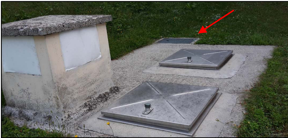
Abbildung 8: Gitter an der Geländeoberfläche bei Tiefbrunnen III
