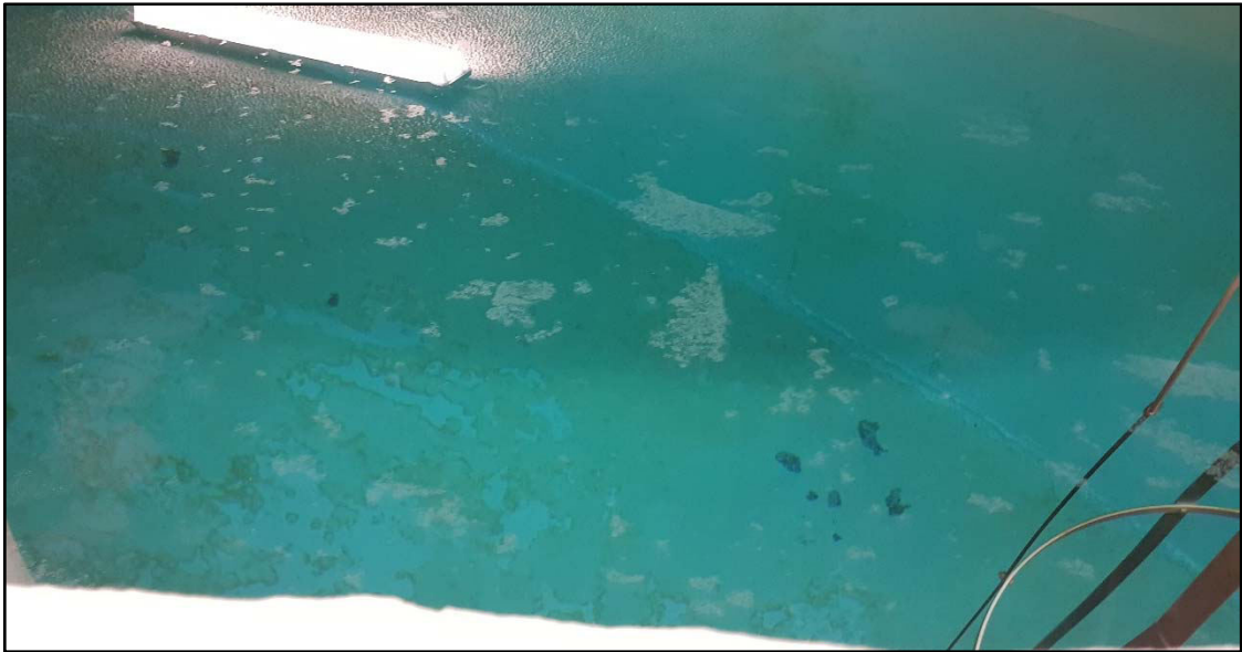
Abbildung 14: Verfärbung und Ablösung der Beschichtung in „Hochbehälter Hochzone“
