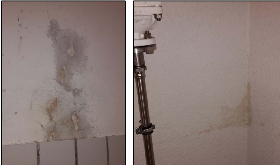
Abbildung 16: Risse und Betonabplatzungen mit Feuchtigkeitsbildung in „Hochbehälter Hochzone“ (linkes Bild) und „Hochbehälter neu“ (rechtes Bild).
