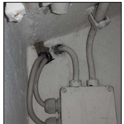
Abbildung 13: Kabeldurchführung bei „Hochbehälter alt“
