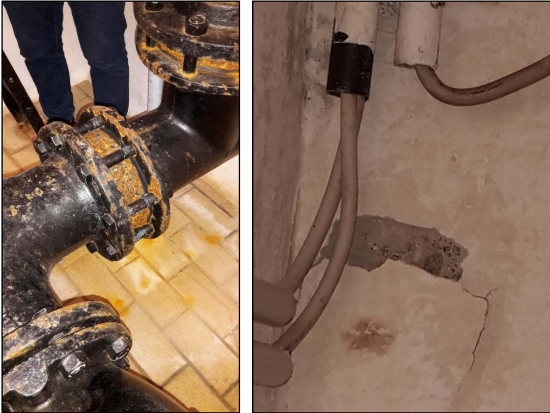
Abbildung 15: Korrosion der Leitungen sowie Risse und Betonabplatzungen an den Wänden von „Hochbehälter alt“
