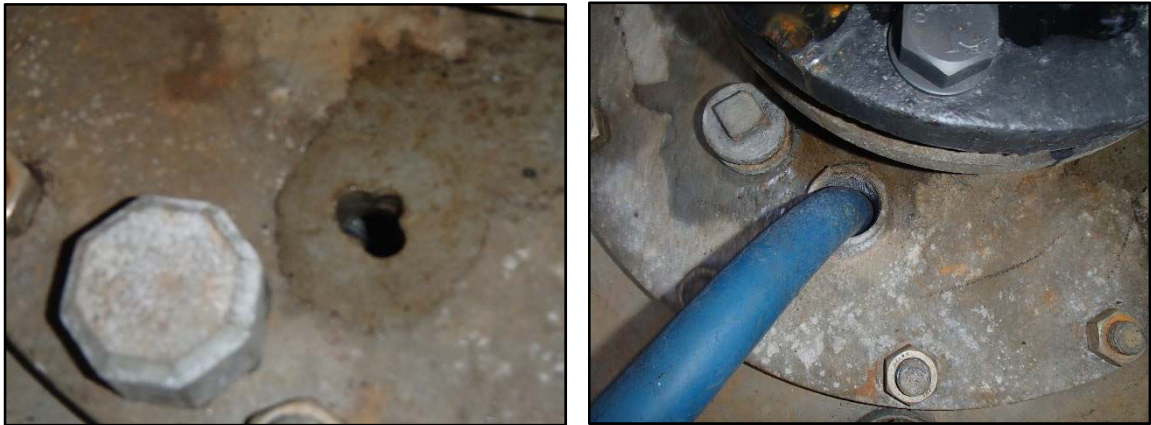
Abbildung 6: Löcher und undichte Stelle bei der Kabelführung am Brunnenkopf Tiefbrunnen III
