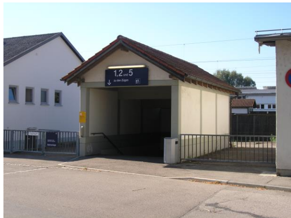
Abb. 62 Barriere am Gleiszugang Bahnhof
