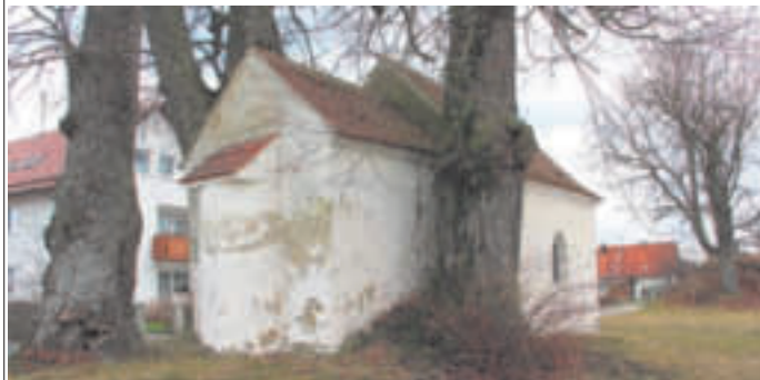
10.1.14: Drei Linden, tiefe Risse in der Kapelle
