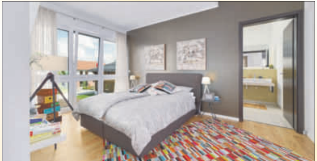
Das gute Raumklima ist auch im Schlafzimmer immer von Bedeutung. Hier sorgt eine kontrollierte Be- und Entlüftungsanlage mit Wärmerückgewinnung für permanente Frischluft. Foto: allkauf haus/interPress
