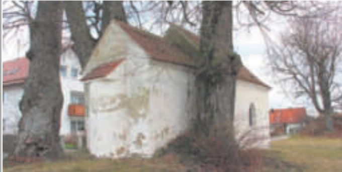
10.1.14: Drei Linden, tiefe Risse in der Kapelle
